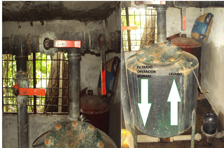
Fotografía tomada de la casa de máquinas de la granja de la USCO
