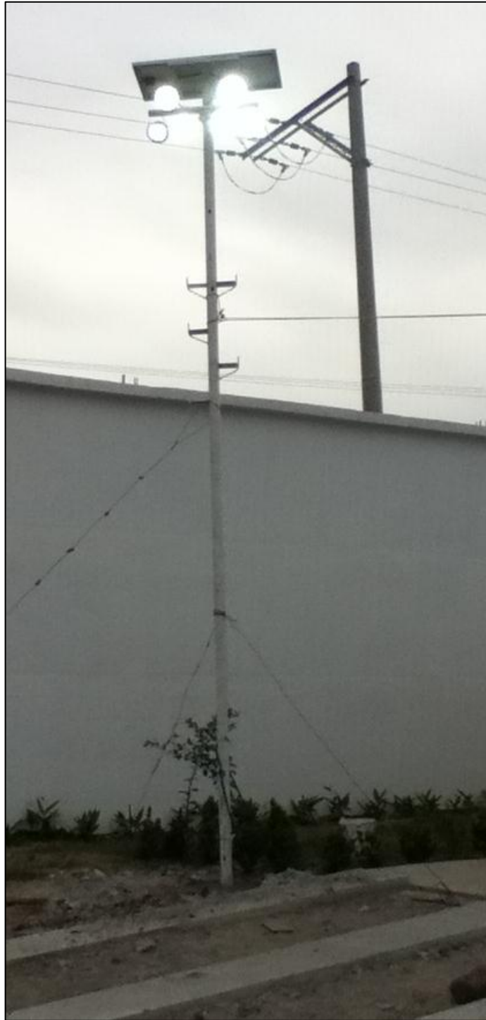
Poste en funcionamiento, (finales de la tarde)
