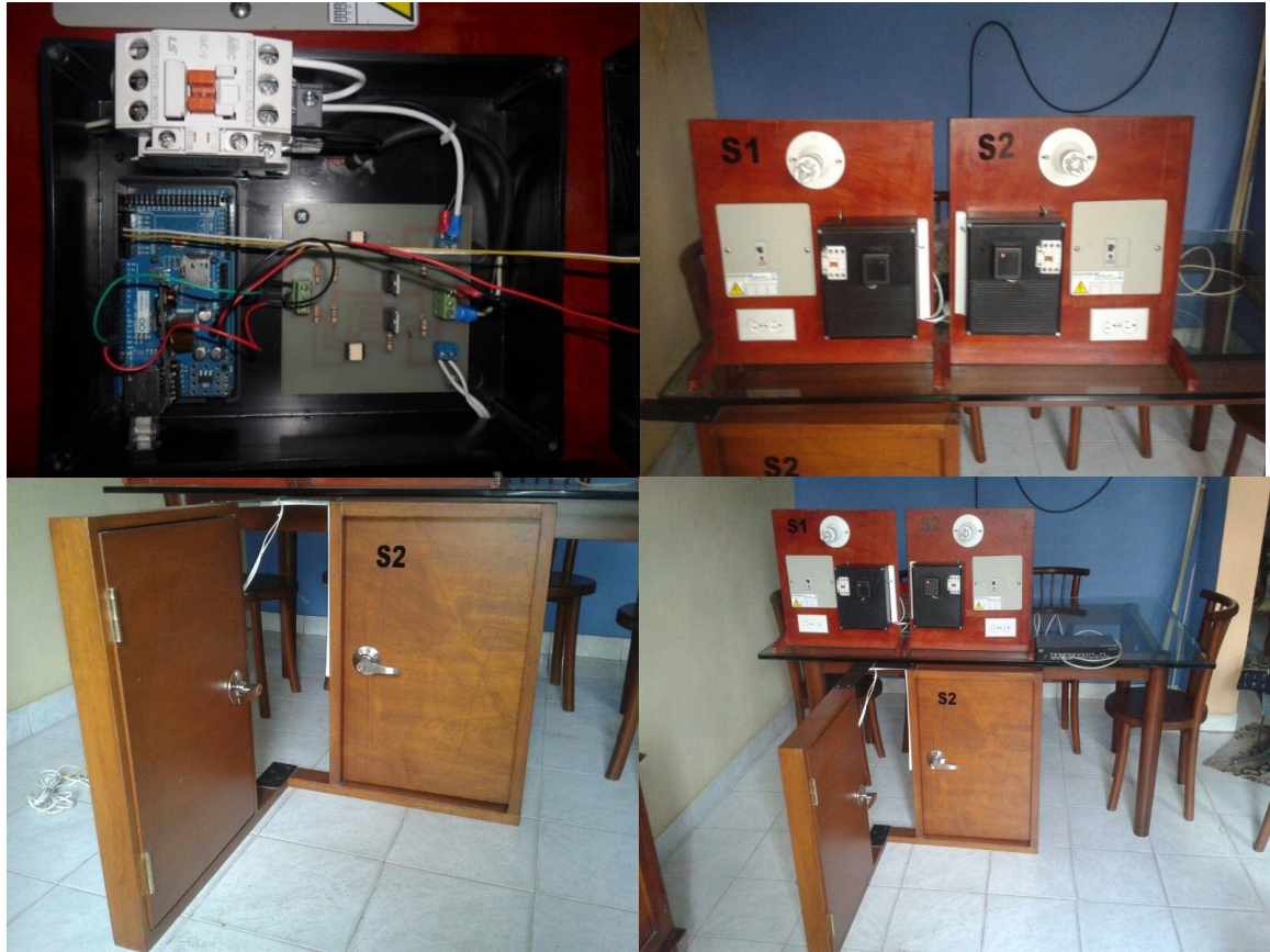
Figura 19. Infraestructura del sistema
