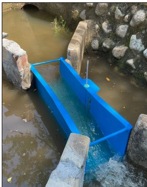
Figura 1. DISPOSITIVO AFORADOR INSTALADO.
