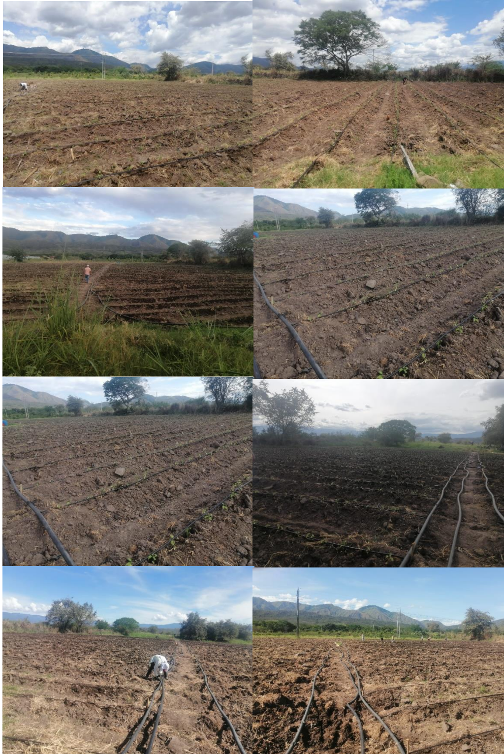
ANEXO 9. Instalación de riego.
