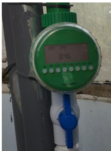
Figura 3. a. Controlador de riego. Fuente: Autor.
