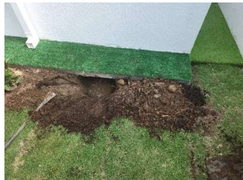
Fotografía 6. Fuga de agua.
