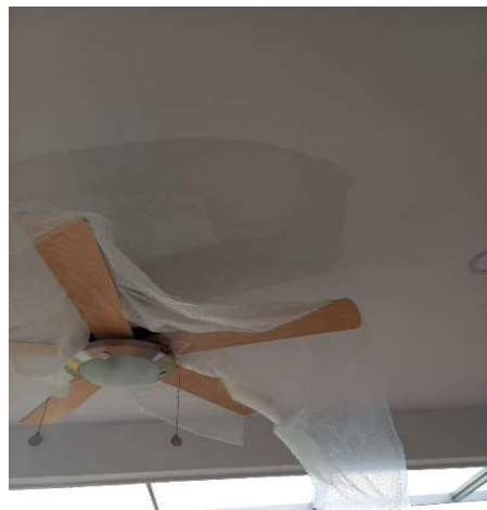
Fotografía 5. Ventilador mal instalado.
