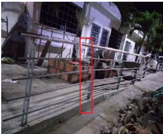
Fotografía 3. Tubos torcidos en reja.
