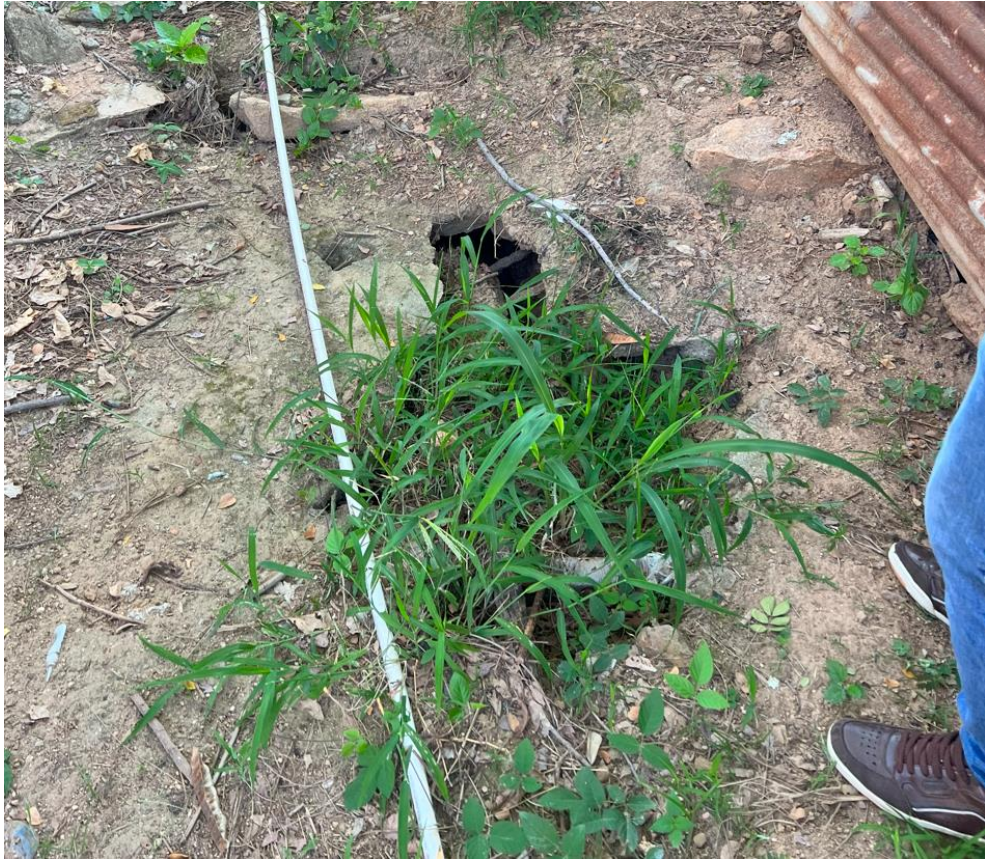
Figura 27 Pozo séptico colapsado.
