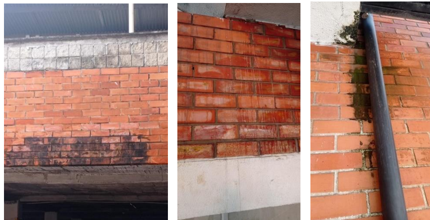
Figura 3-17: Lesiones como humedades, ensuciamiento, eflorescencias, erosiones puntuales. Fuente: propia.
