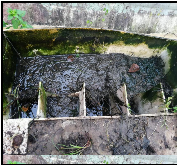
Figura 21. Caja de distribución del caudal
