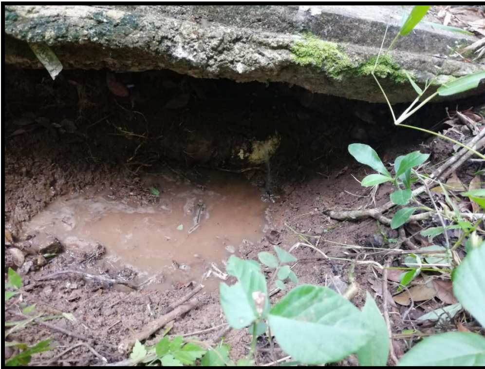
Figura 29. Tubería rota del reactor al lecho de secado
