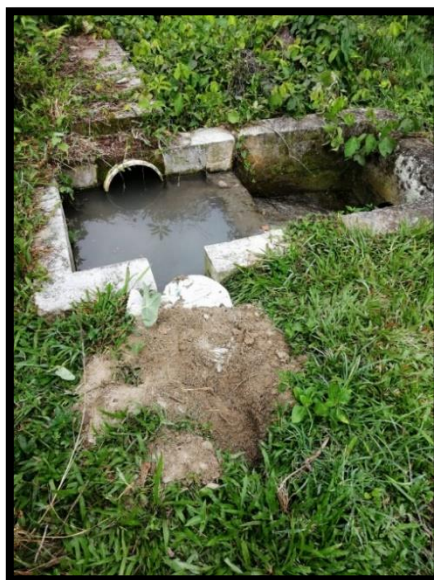
Figura 13. Desvío de agua residual a la quebrada Órganos
