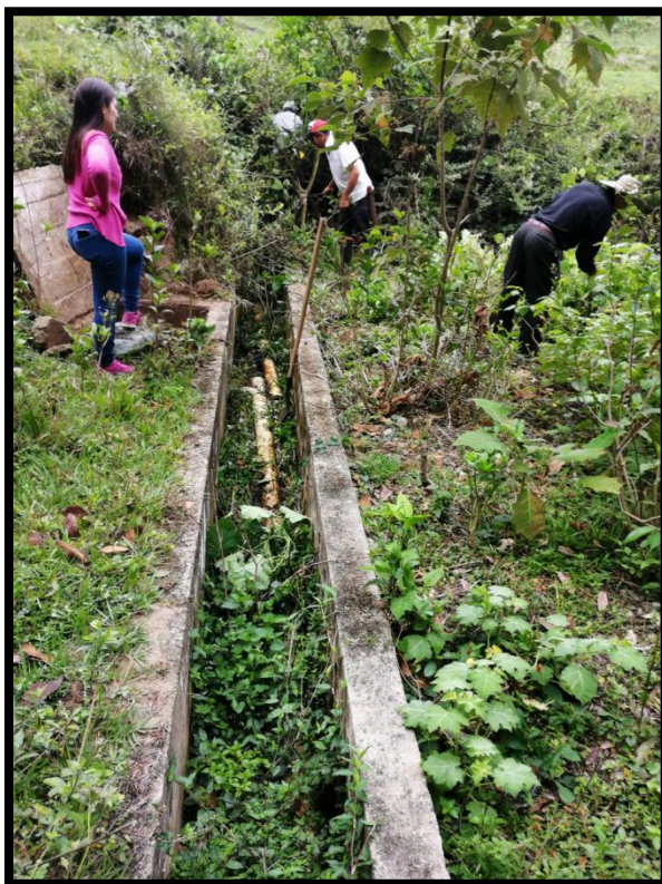
Figura 31. Sistema múltiple colector de la salida del humedal
