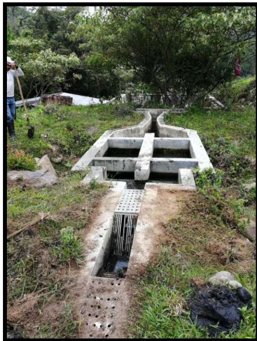
Figura 12. Vista de toda la PTAR San Luis
