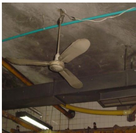
Ventiladores en mal estado.
