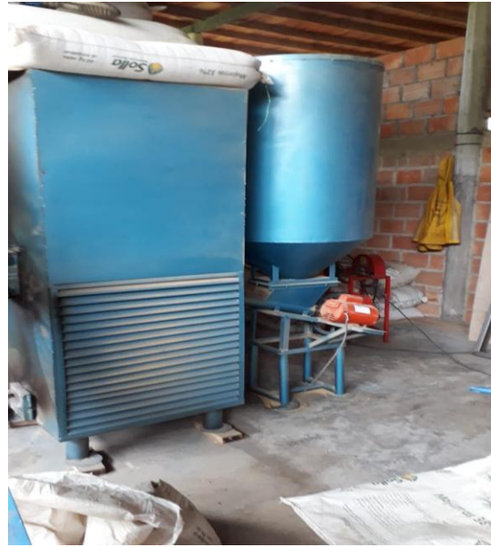
Figura 20. Entrada de aire al intercambiador de Calor
