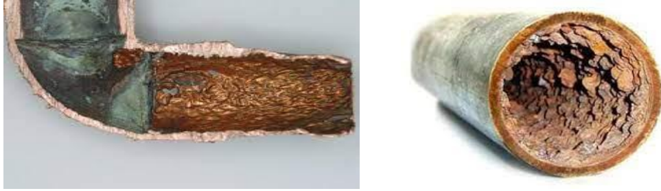
Figura 7. Tipología de corrosión por bajo depósito Fuente: Tomado de Gonzáles, 2016.
