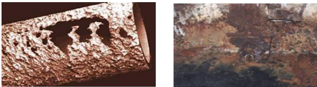
Figura 3. Tipología de corrosión generalizada Fuente: Tomado de Palacios y Vega, 2004.
