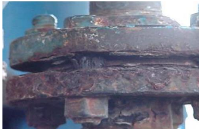
Figura 6. Tipología de corrosión por grietas Fuente: Tomado de Palacios y Vega, 2004.
