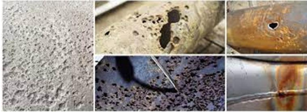
Figura 5. Tipología de corrosión por picadura Fuente: Tomado de Amarine, 2020.
