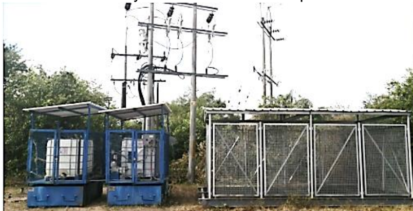
Figura 31 Skid de dosificación y almacenamiento de química antiderrame
