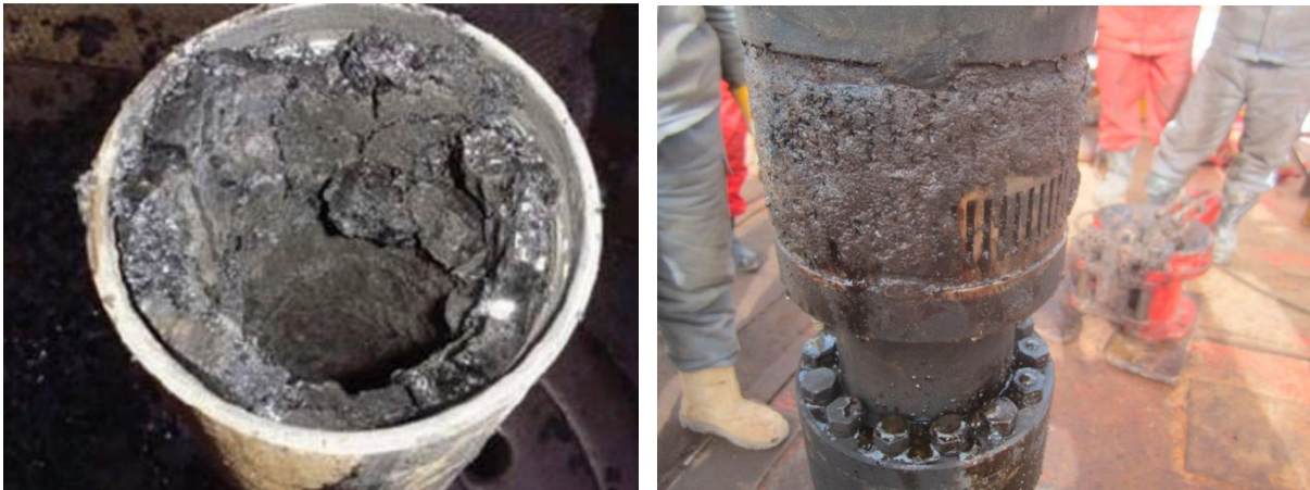
Figura 10. Asfaltenos depositados en una tubería de producción (izquierda) y sobre la superficie de un sistema de producción electrosumergible (derecha).
