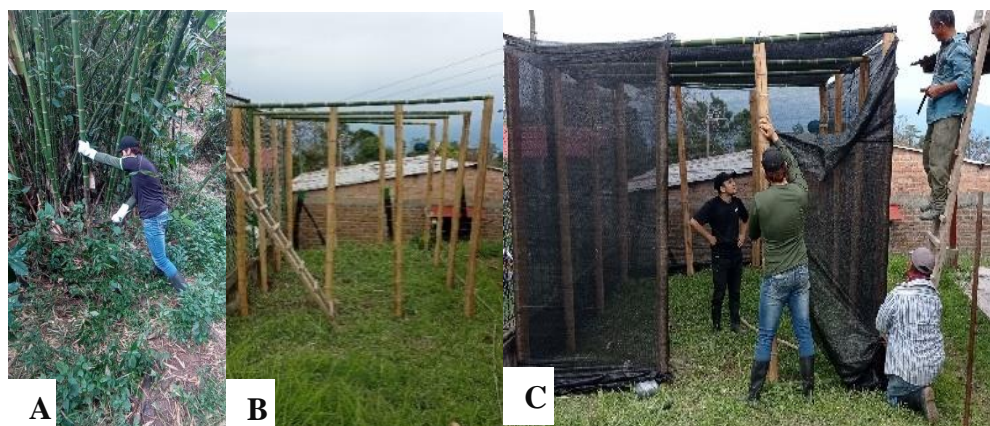
Figura 4. Construcción del vivero. a) Colecta de materiales para la construcción. b) Construcción de la estructura. c) Instalación de la polisombra para protección de las plantas.
