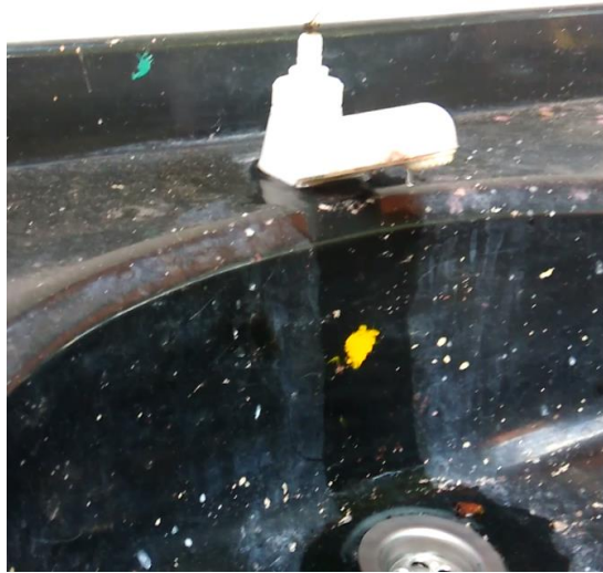
Figura 62. Llave en muy mal estado.
