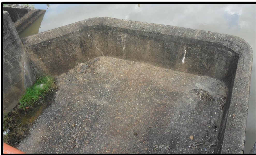
Figura 31 Vertedero Zona de Bombeo (Vasquez A & Carvajal A, 2018)
