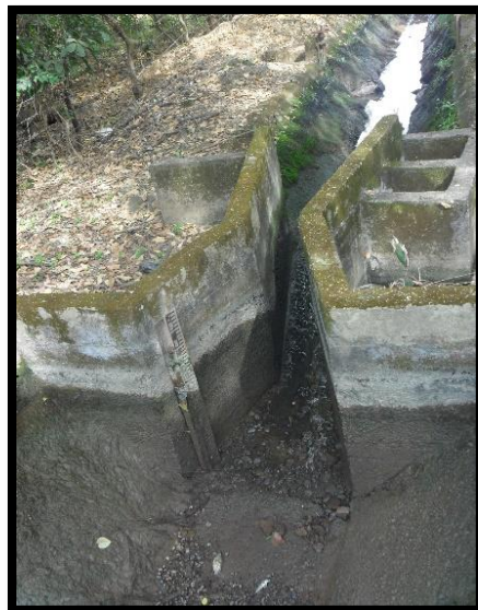
Figura 20 Canaleta Parshall Zona de Rebombeo (Vasquez A & Carvajal A, 2018)
