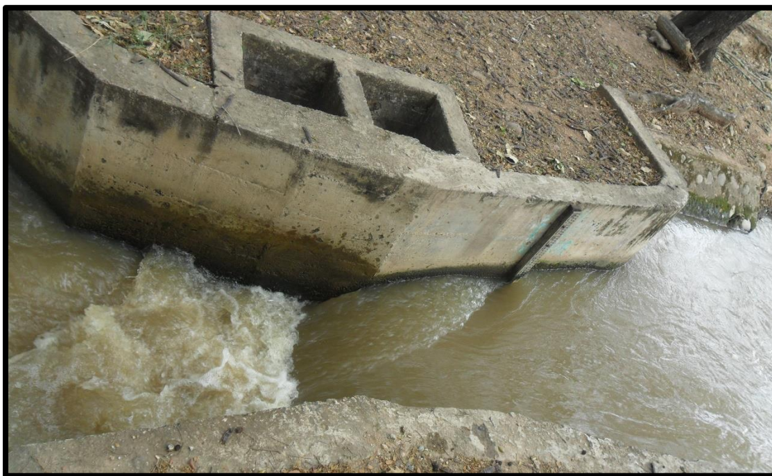
Figura 32 Canaleta Parshall Zona de Bombeo (Vasquez A & Carvajal A, 2018)
