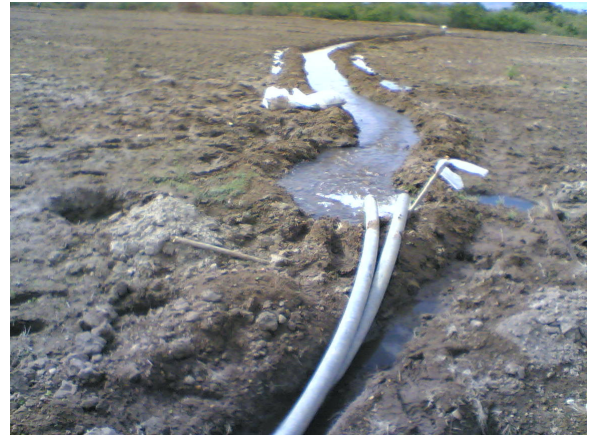
b) Descarga unidad de bombeo
