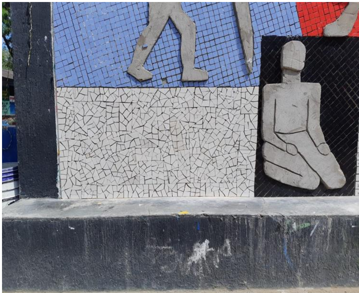
Fotografía 116 Pegado de mosaico beis del lado izquierdo parte de abajo ya terminado
