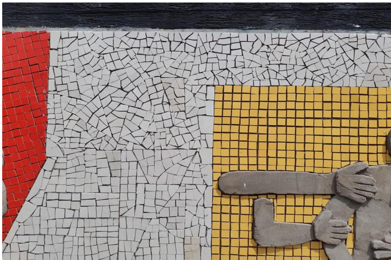
Fotografía 99 Pegado de mosaico asimétrico beis del centro izquierdo parte de arriba ya terminado
