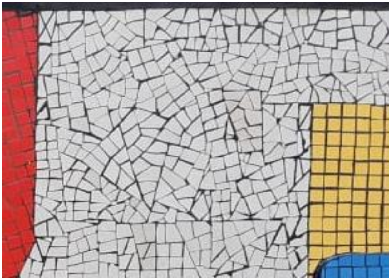
Fotografía 178 Centro del mural fondo beis de las figuras ya emboquillado parte izquierda de arriba
