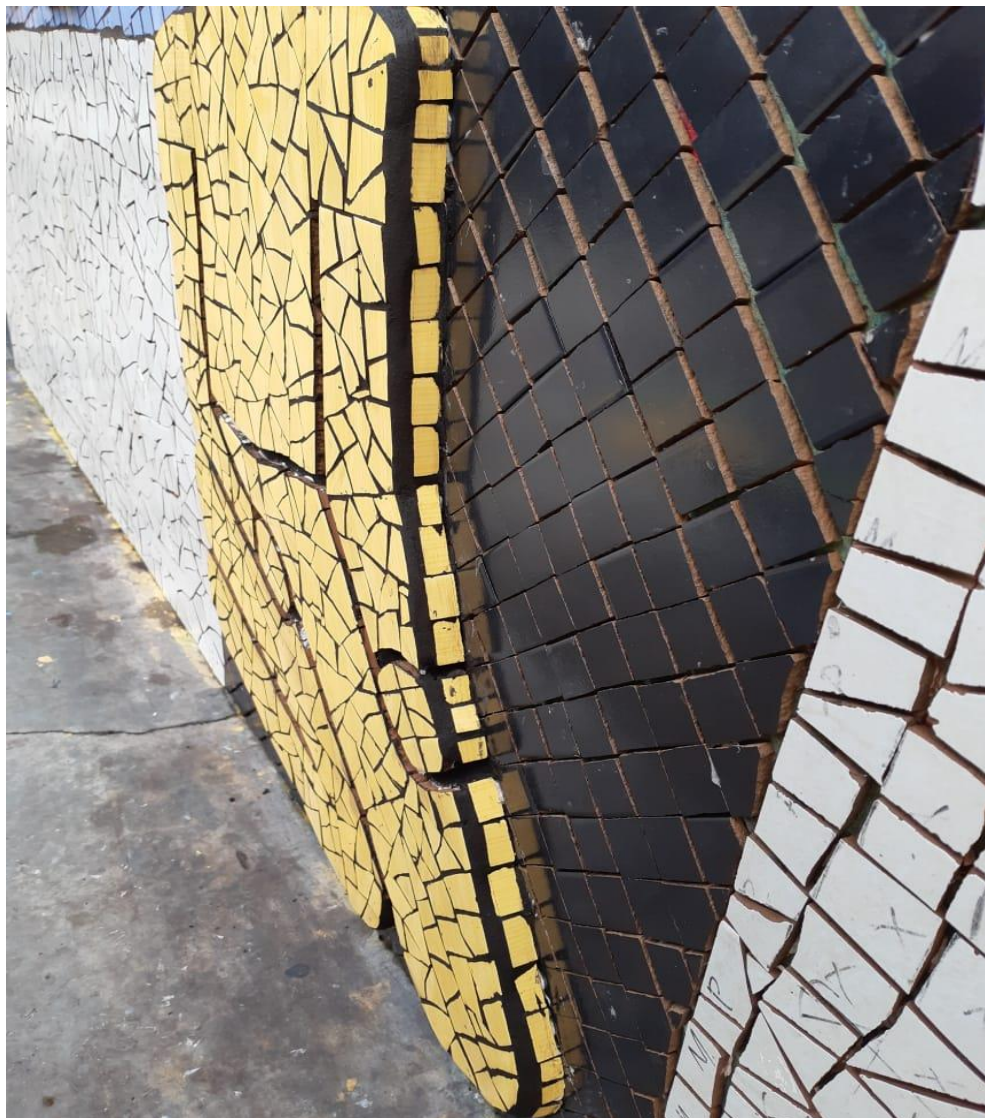
Fotografía 202 Emboquillado y limpieza de una las figura (violencia religiosa ) del lado izquierdo parte de abajo ya emboquillada contorno exterior lado derecho
