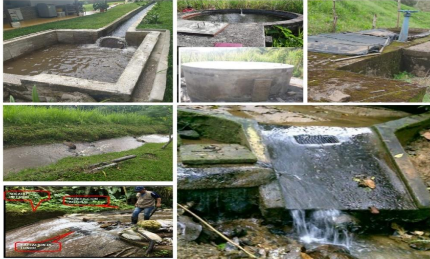
FIGURA 4. Componentes y obras hidráulicas del sistema de suministro de agua en estado favorable.
