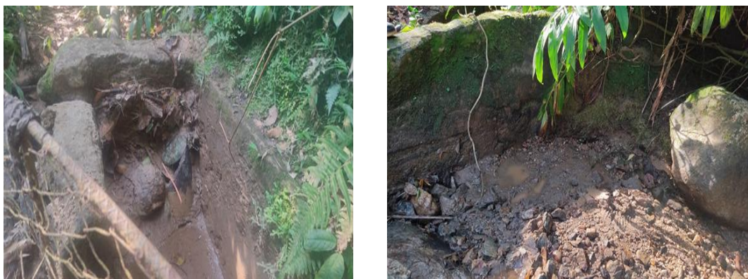
FIGURA 6: Obstrucción parcial en los componentes de los sistemas de suministro de agua
