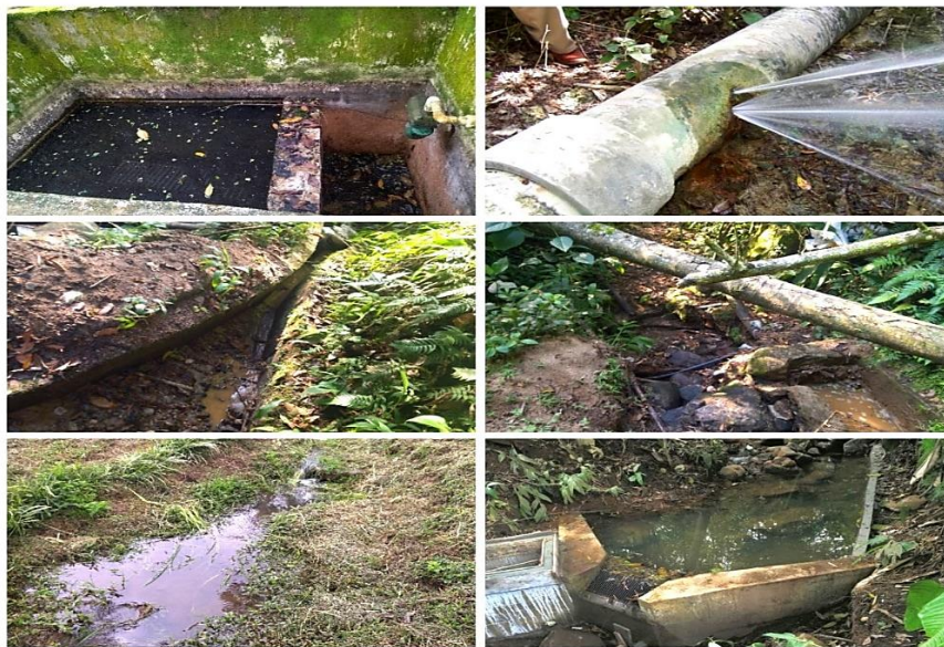
FIGURA 5. Componentes y obras hidráulicas del sistema de suministro de agua en estado desfavorable
