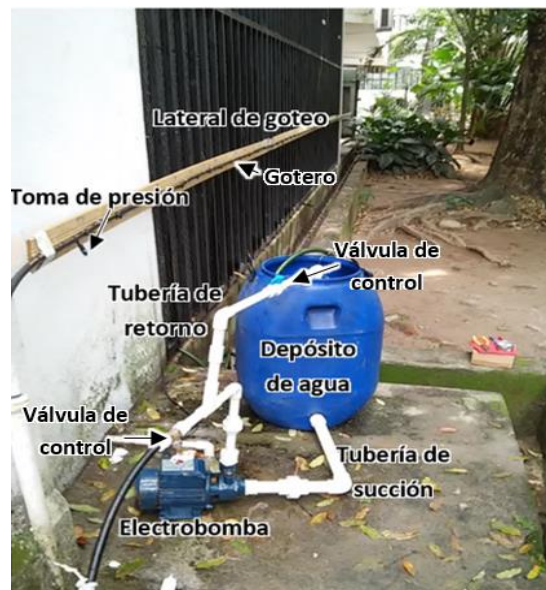
Figura 3. Sistema de bombeo y lateral de riego por goteo empleados para el estudio.
