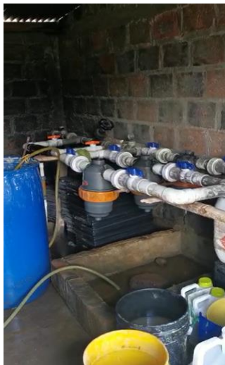
Anexo 3. Cabezal de riego.
