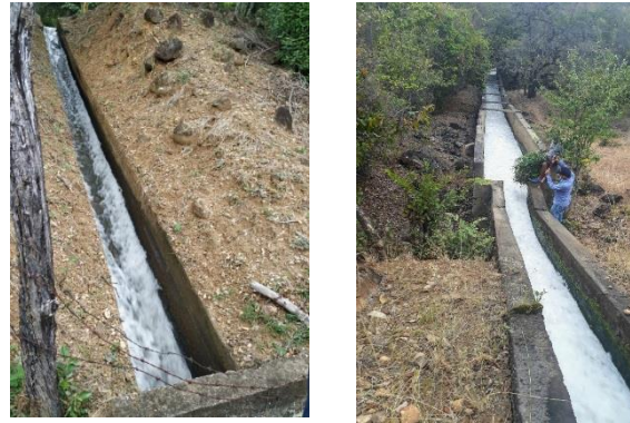
FIGURA 2. Canal de conducción: Punto de aprovechamiento energético “La Parrilla” (Ramírez Ramírez & Cerquera Valderrama, 2020).
