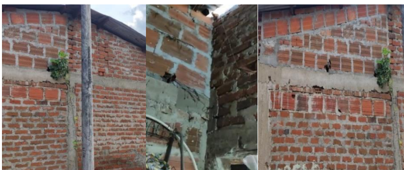
Figura 8. Evidencia de la irregularidad en altura de la casa No. 13.
