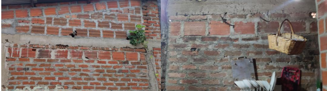
Figura 10. Evidencia del tipo y disposición de las unidades de mampostería de la casa No. 13.
