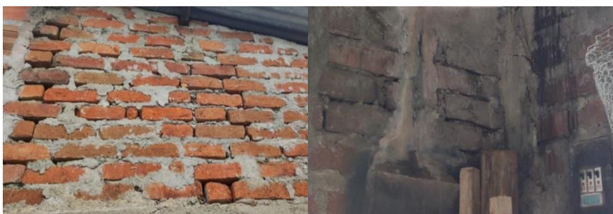
Figura 9. Evidencias de la calidad de juntas de pega en mortero de la casa No. 13.
