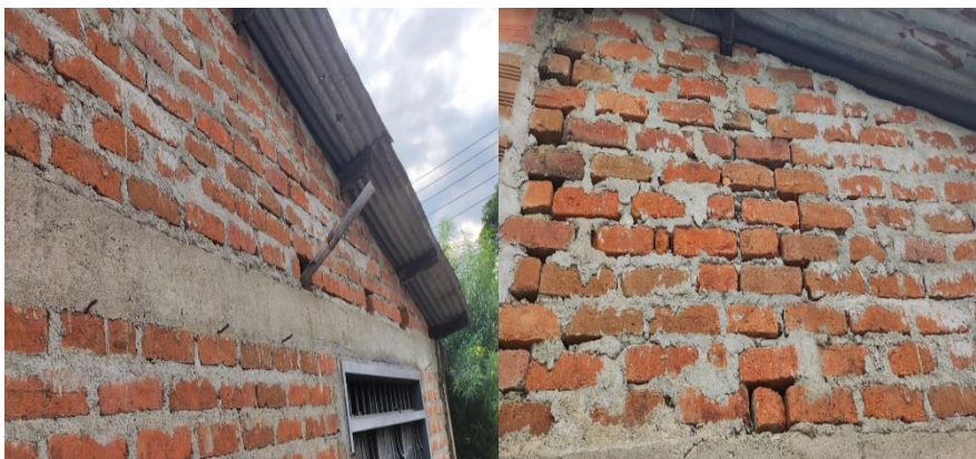
Figura 14. Evidencia de las vigas de amarre o corona de la casa No. 13.
