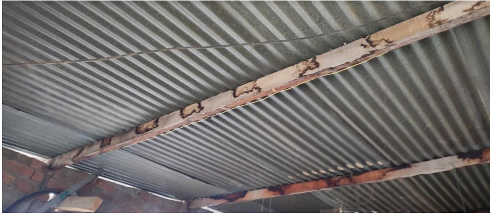
Figura 15. Evidencia de los amarres de cubierta de la casa No. 13.
