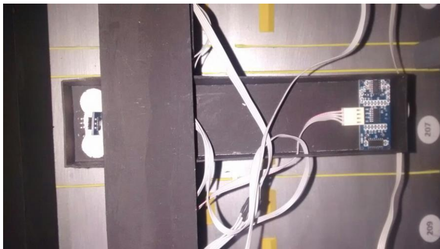
Figura 30. Cajas de la ubicación de los sensores
