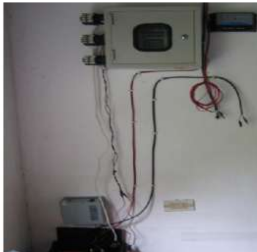
Figura 27. Programador digital con energía solar
