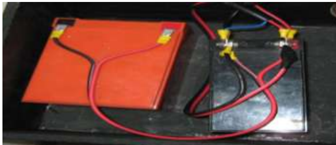
Figura 13. Baterías del sistema
