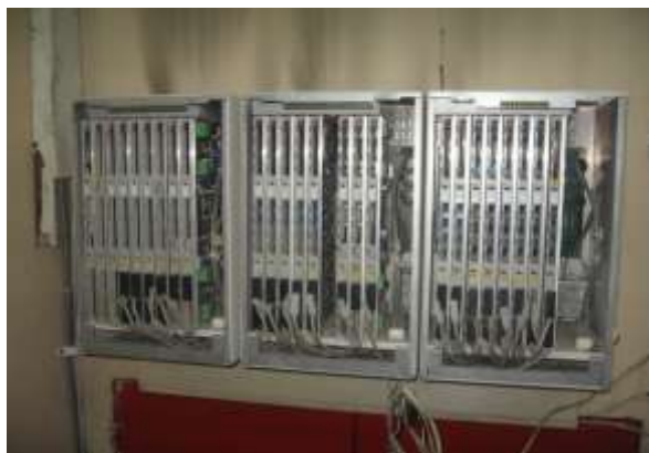
Figura 1 Planta PBX Ericsson BP-150 – Sede Central
