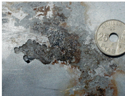
Figura 1. Perforación por corrosión en una tubería enterrada de acero inoxidable AISI 304L
