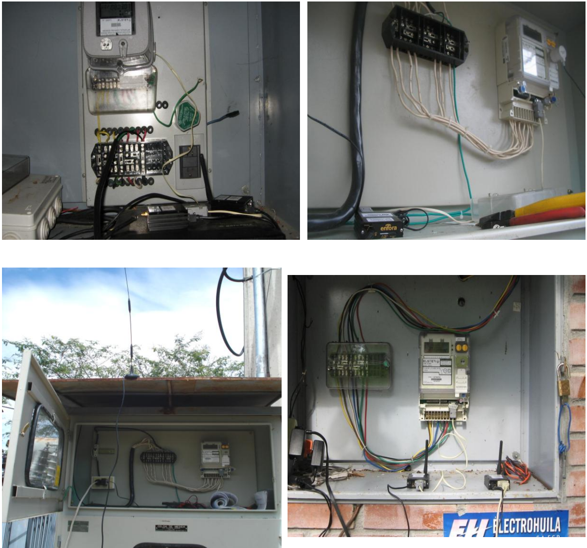
Figura 6: Fotos de la instalación del sistema.
