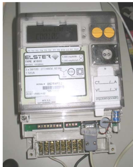
Fig. 20 Medidor Elster A1800
