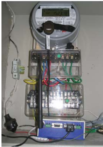
Fig. 53 Equipo de comunicación instalado CAS RS2000
