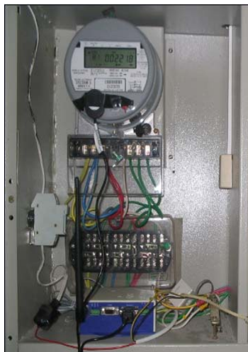
Fig. 54 Equipo de comunicación instalado CAS RS2000
