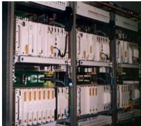
Figura 1.4.2.14 Repartidores y multiplexores ópticos
