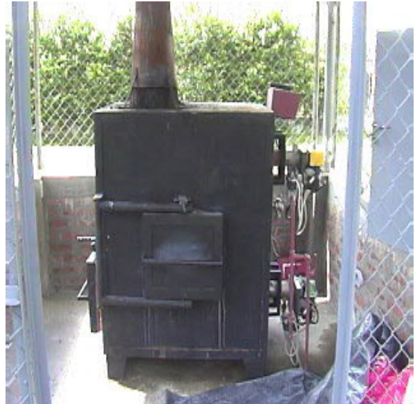
Fotografía 21. Vista frontal del horno incinerador
