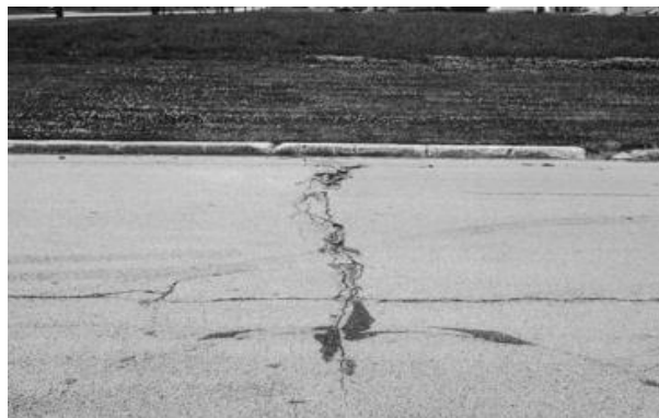
Figura 6-11 Grieta longitudinal y/o transversal, severidad alta.
