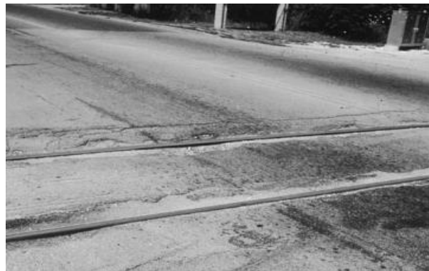
Figura 6-15 Cruce de vía férrea, severidad media.
