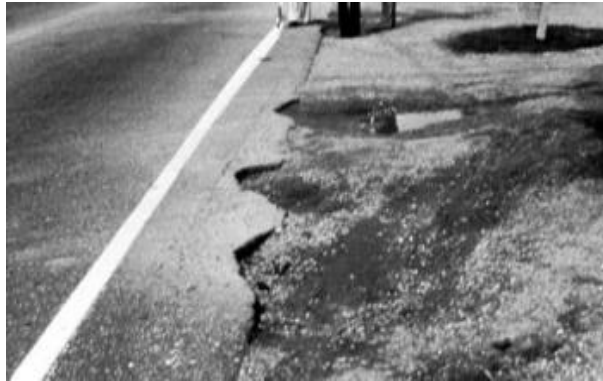
Figura 6-8 Grieta de borde, severidad alta.
