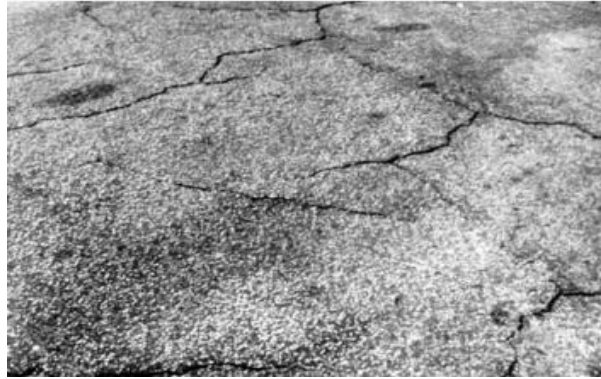
Figura 6-4 Agrietamiento de bloques, severidad alta.
