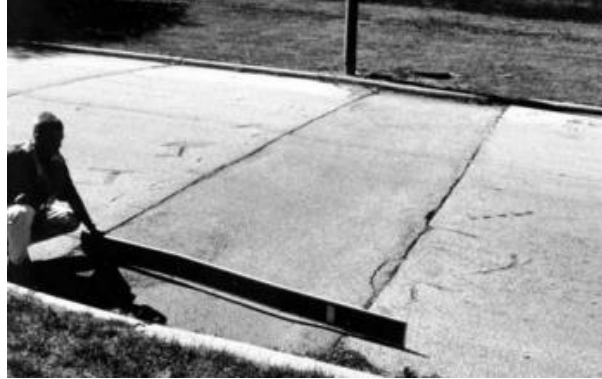
Figura 6-12 Parche y/o acometida de servicios, severidad media.
