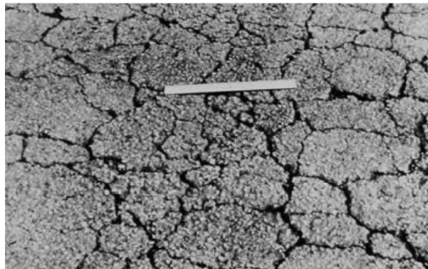
Figura 6-1 Agrietamiento de Cocodrilo, severidad alta.
