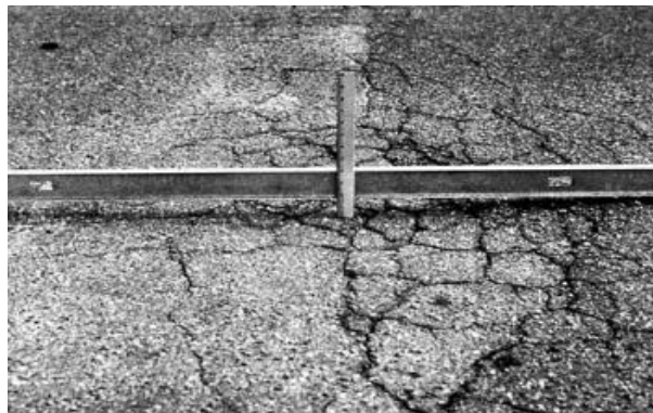
Figura 6-7 Depresión, severidad alta.
