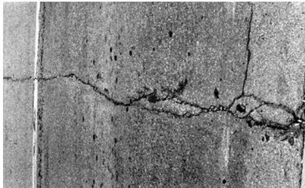
Figura 6-9 Grieta de reflexión de juntas, severidad media.
