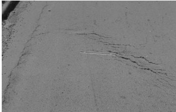
Figura 6-18 Grietas parabólicas / media luna, severidad media.
