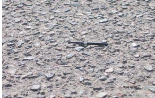
Figura 6-20 Meteorización, severidad alta.
