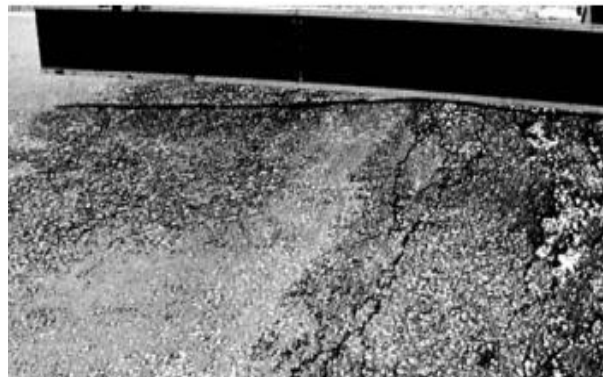
Figura 6-5 Abultamientos y hundimientos, severidad alta.
