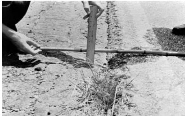
Figura 6-10 Desnivel carril/berma, severidad media.
