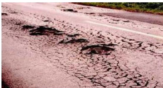
Figura 3-8 Mezcla asfáltica que requiere reconstrucción.
