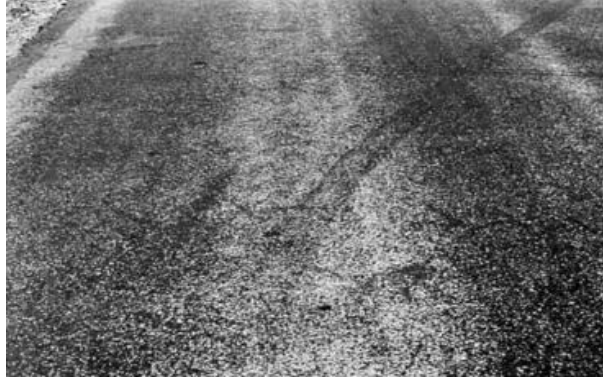
Figura 6-2 Sangrado o Exudación, severidad baja.
