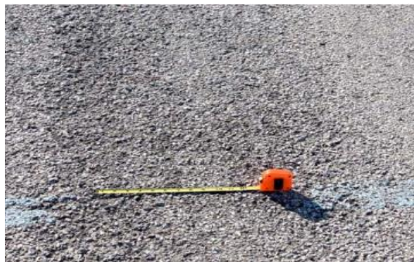
Figura 6-19 Desprendimiento de agregados, severidad media.
