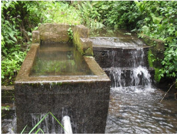
Bocatoma Acueducto veredal Alto Primavera
