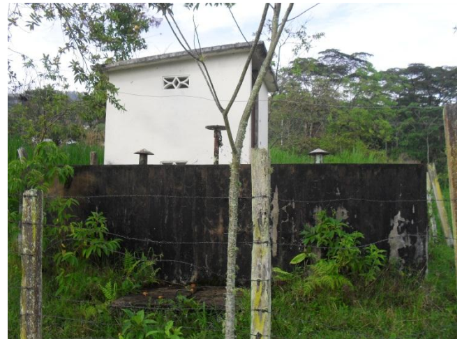
Tanque de almacenamiento Bocatoma Acueducto veredal la Esperanza
