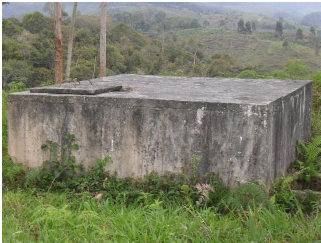
Tanque de almacenamiento del Acueducto veredal Alto Primavera
