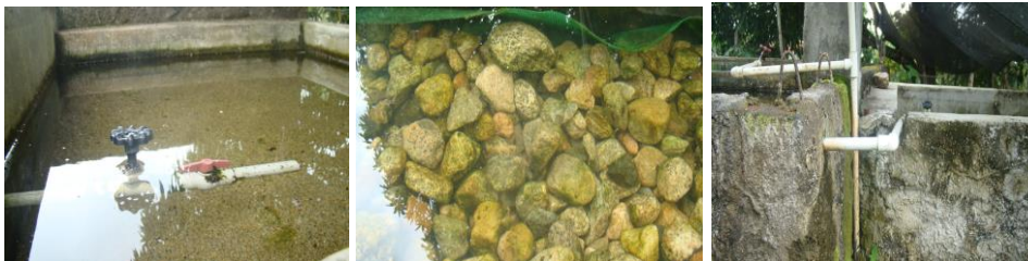
Foto 64, 65 y 66. Sistema de Filtrado agua acueducto. Bernardo Murcia. Finca Villa Stefany. Vereda Termopilas.
