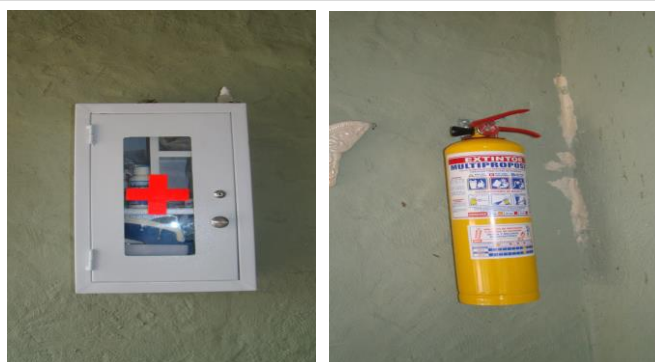
Fotos 97 y 98. Botiquín y extintor. María Yolanda Castañeda. Finca Vega del Puente. Vereda Termopilas.
