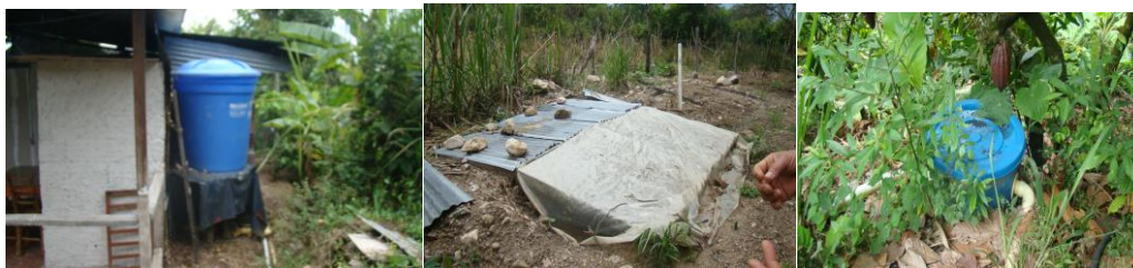
Foto 61, 62 y 63. Sistema de tratamiento a aguas residuales. Bernardo Murcia. Finca Villa Stefany. Vereda Termopilas.
