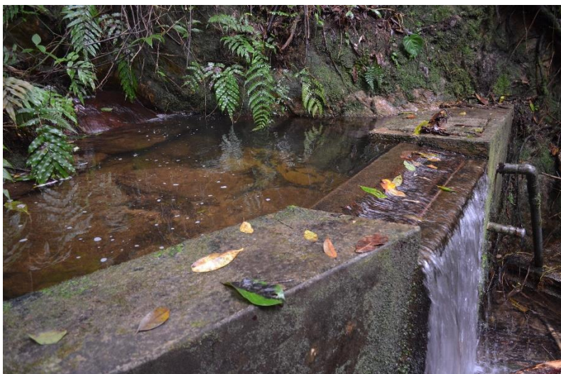
Figura 2. Bocatoma ubicada en la vereda La Cumbre
