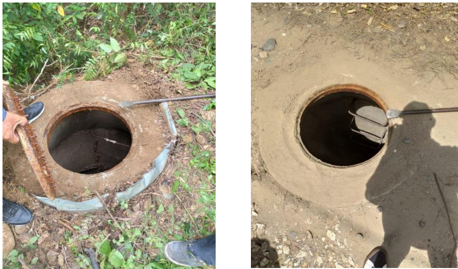
Figura 3-8: Visualización del estado de los pozos.
