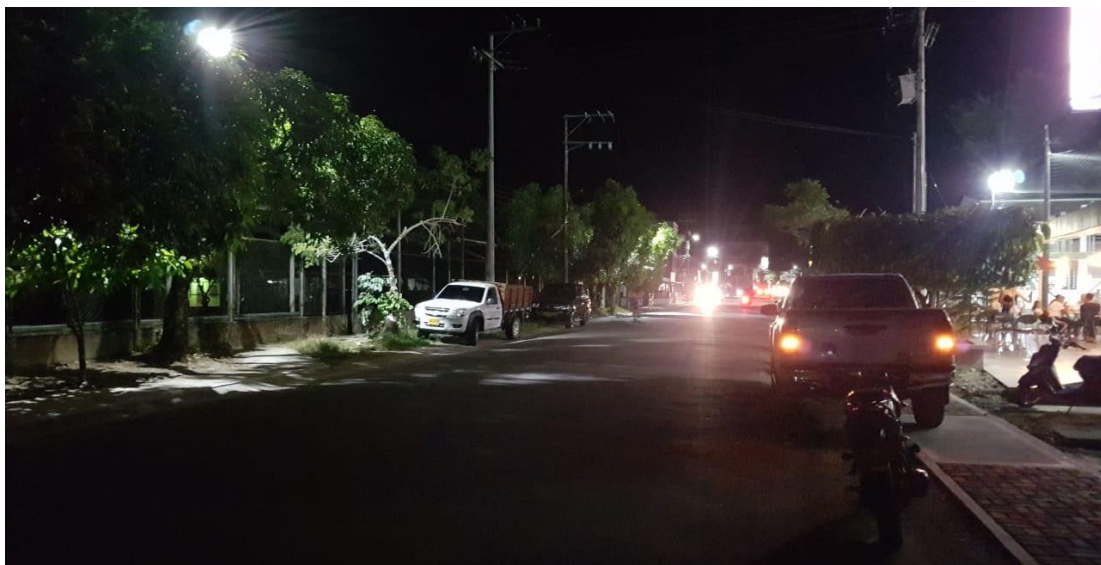
Fotografía 4-8: Estado de la iluminación pública, Puerto Caicedo-Putumayo. Tomada por los investigadores subtramo K0+400 hasta K0+500
