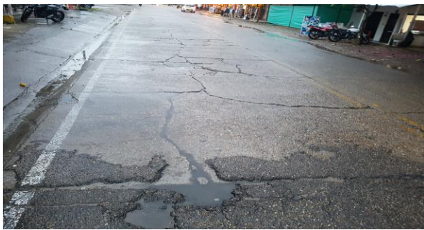
Fracturación múltiple en pavimento rígido y descascamiento en junta de pavimento flexible.
