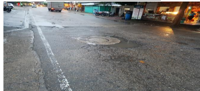
Bache y fisuras junto a pozo de inspección.
