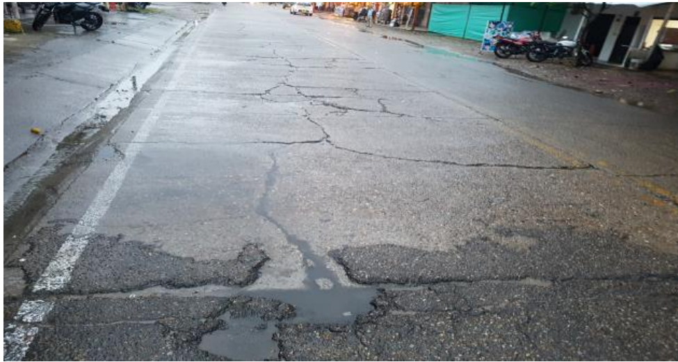
Fotografía 4-7: Estado del pavimento. Tomada por los investigadores subtramo K0+700 hasta K0+800.
