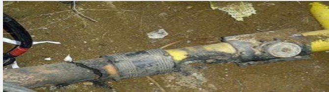
Figura 12 Afección eléctrica y/o térmica
