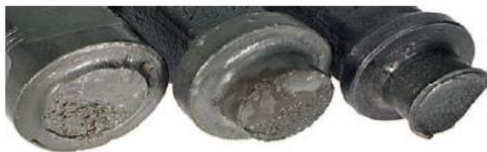
Figura 35. Fallas por conexión.
