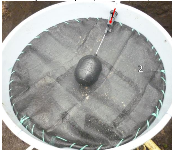
Figura 22.) Recamara dosificadora válvula con flotador de entrada y válvula de paso. (Coocentral, 2017).
