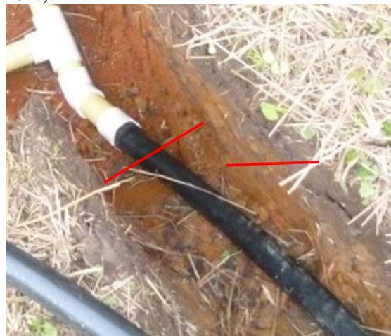
Figura 26.) Tubería de conexión. (Coocentral, 2017).
