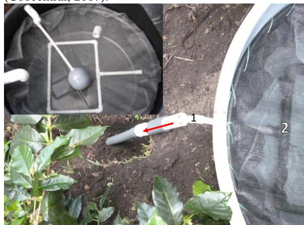
Figura 23.) Salida de lavado y válvula de dosificación de flujo que alimenta el Reactor Metanogénico. (Coocentral, 2017).
