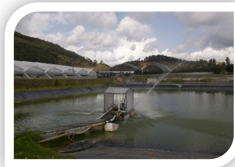
Fig. 13 Caseta de bombeo de la Finca Marly
