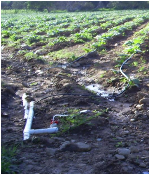
Fotografía 51 Válvulas Sin Cajillas de Protección
