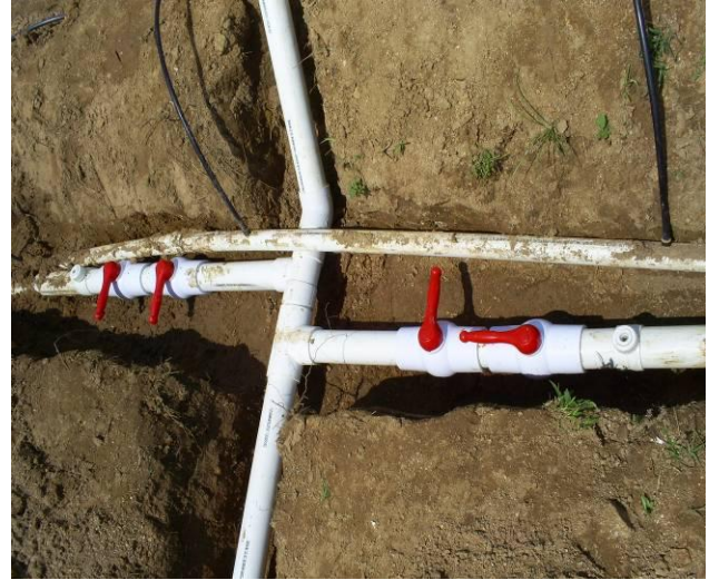
Fotografía 29 Válvulas Control de Presión, Caudal Para Dos Sectores, Tapón Lavado Principal, Conexiones Múltiple Lateral
