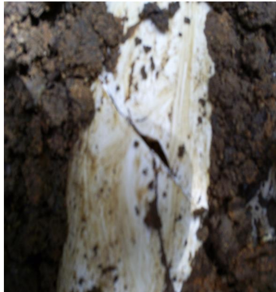
Fotografía 52 Tubería Rota por Paso de Cultivadora
