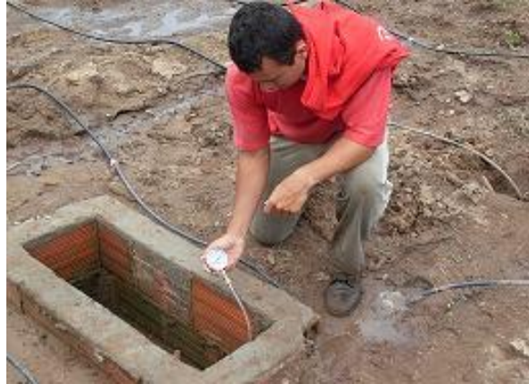
Fotografía 40 Calibración de los Sectores de Riego
