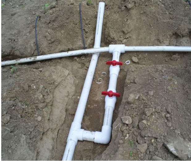
Fotografía 28 Válvulas Control de Presión, Caudal y Tapón de Lavado Tubería Principal
