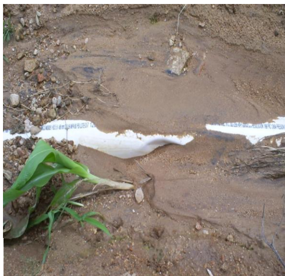
Fotografía 50 Deformación de Tubería por Paso de Maquinaria Sobre Tubería Mal Tapada
