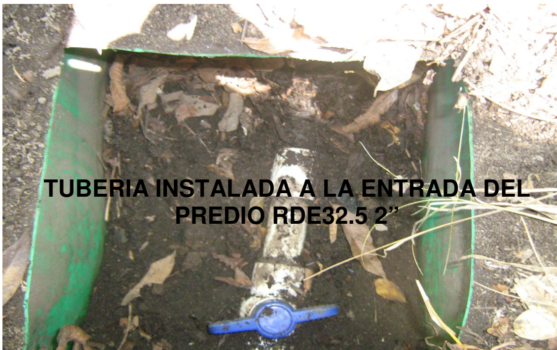
Fig. N.11. Toma predial instalada en el lote, derivada del distrito de riego El Espinal.
