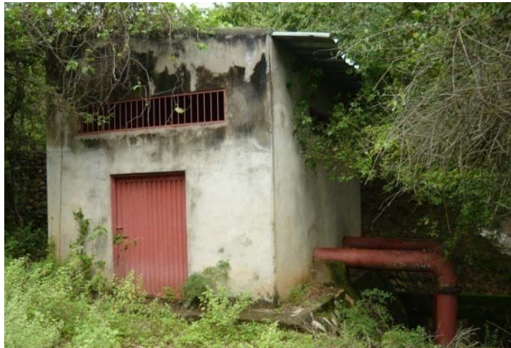
Foto 3 Caseta de bombeo distrito Doche
