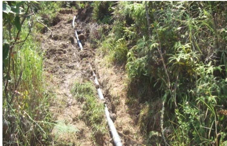
Foto 4 Tubería de tipo p.v.c. distrito Asohorizonte
