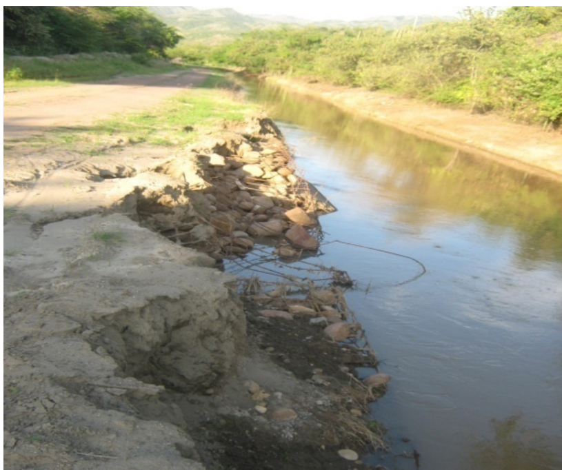
Foto 8. Deterioro del canal del distrito San Alfonso
