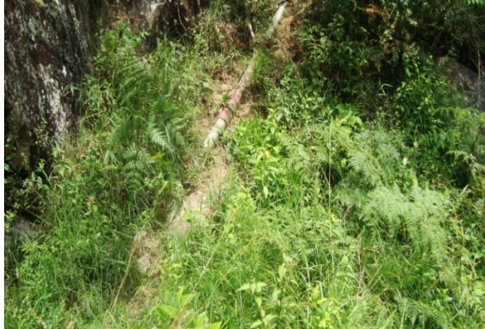
Foto 5 Tubería de tipo p.v.c. distrito San Antonio Bajo
