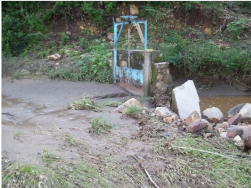
Foto 10. Sobresedimentación bocatoma distrito Doche
