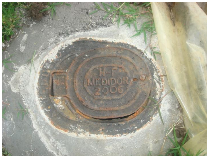
Foto 15. Infraestructura del servicio de acueducto De la finca La Cabaña.
