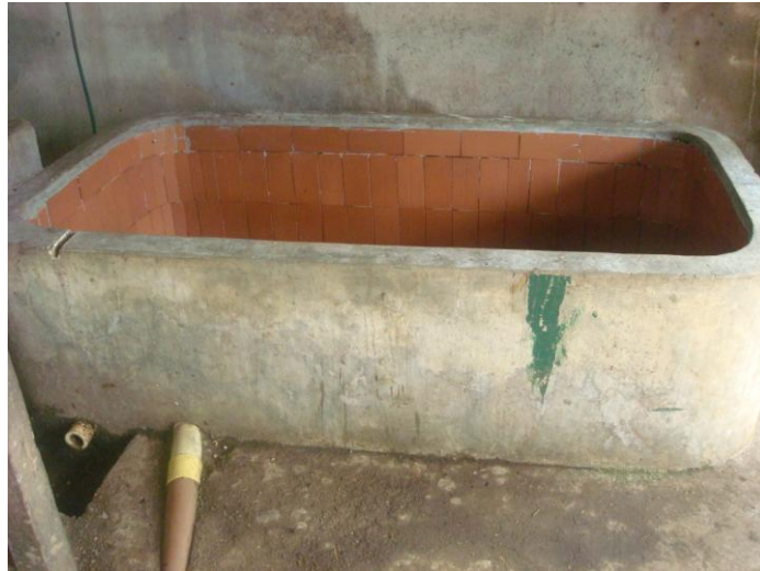
Foto 6. Tanque de lavado de la finca La Cabaña.
