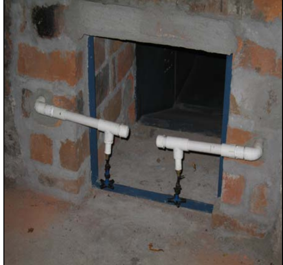
Figura 4. Sistema de humidificación por nebulización del Horno de curado por convección forzada USCO – MADR
