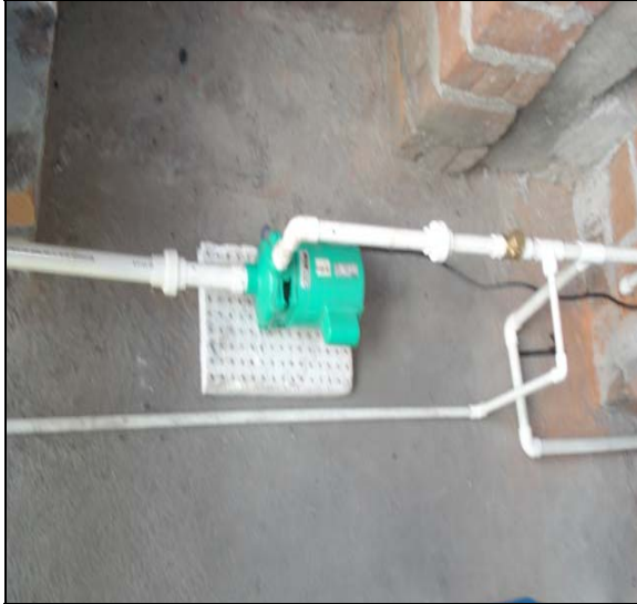
Figura 3. Vista del sistema de bombeo del sistema de nebulización del Horno de curado por convección forzada USCO – MADR
