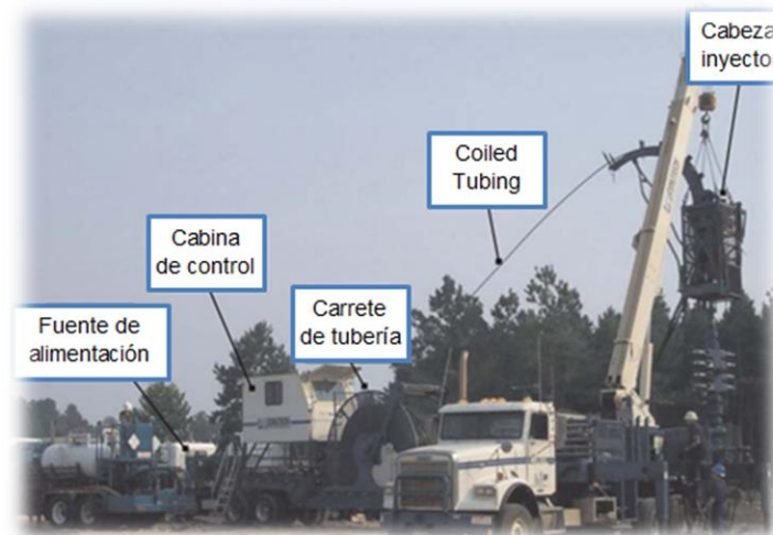
Figura 26. Montaje de la Unidad de Coiled Tubing
