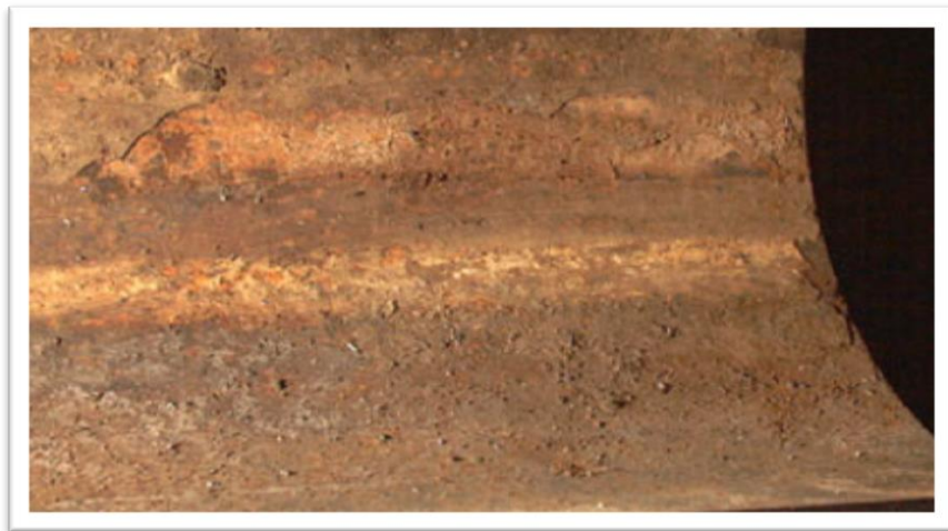
Figura 1 Corrosión general o uniforme
