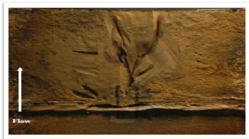
Figura 4 Corrosión localizada – erosión
